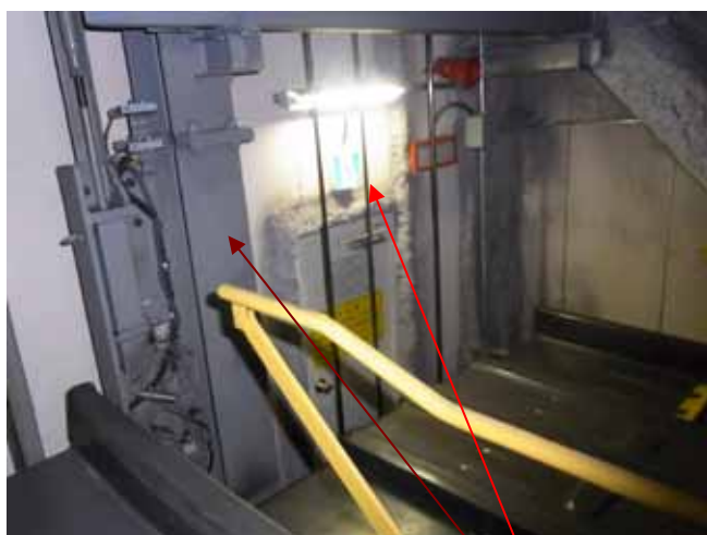
写真5 点検口の設置状況 昇降装置は、乗降室で操作するため、点検口へはトラップを使用して移動する。
