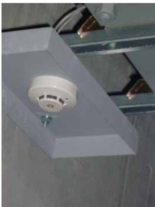
写真8 光電式スポット型感知器の設置状況 (設置間隔；高さ約9.6m)
